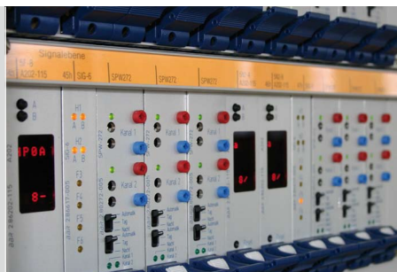
Träger mit Baugruppen
