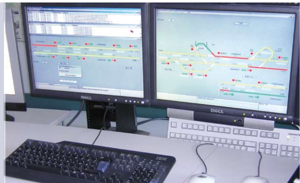
Bedienplatz-Monitore mit Gleisbildern
